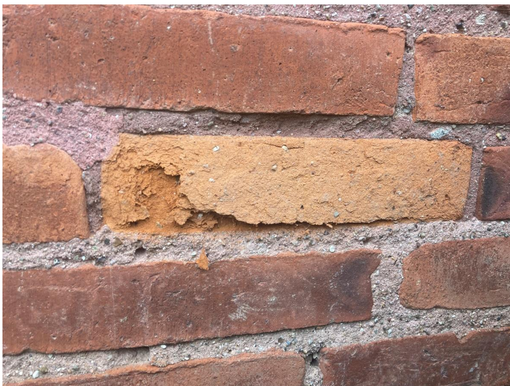
Foto 14. Typiske skader på mursten
