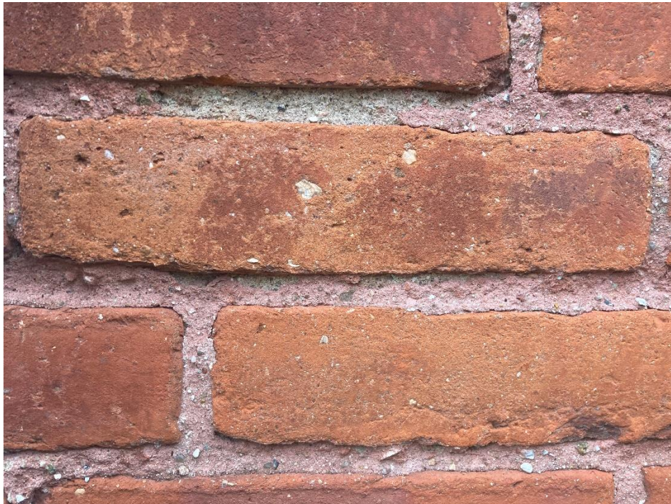
Foto 17. Typiske skader på mursten
