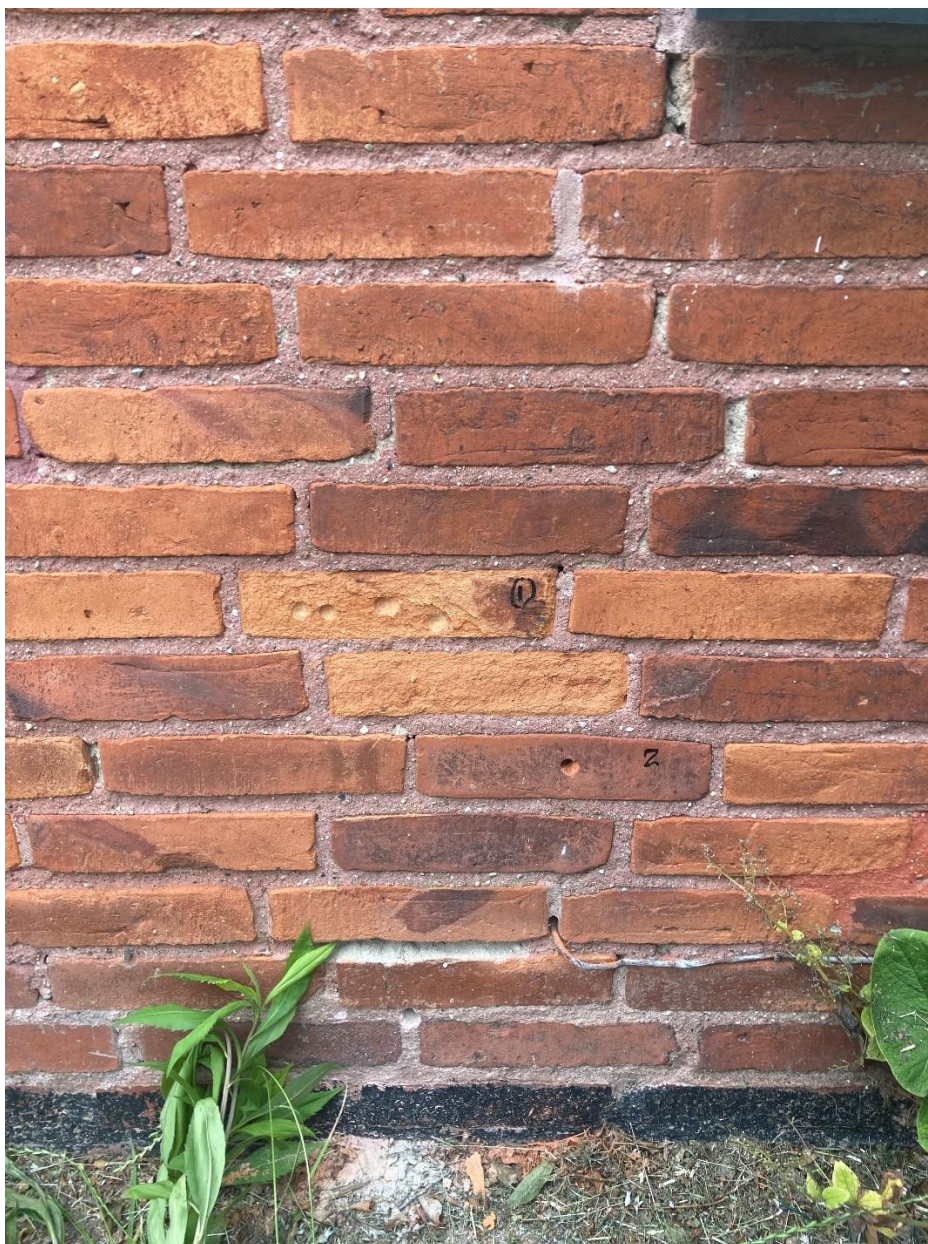
Foto 21. Mursten testet for saltindhold. Stenen markeret med "1" har et forhøjet saltindhold på 2.6 %. Stenen markeret med "2" har et ikke-forhøjet saltindhold på 0.2 %.
