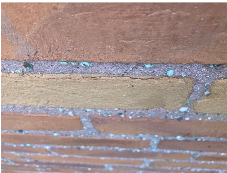
Foto 15. Typiske skader på mursten
