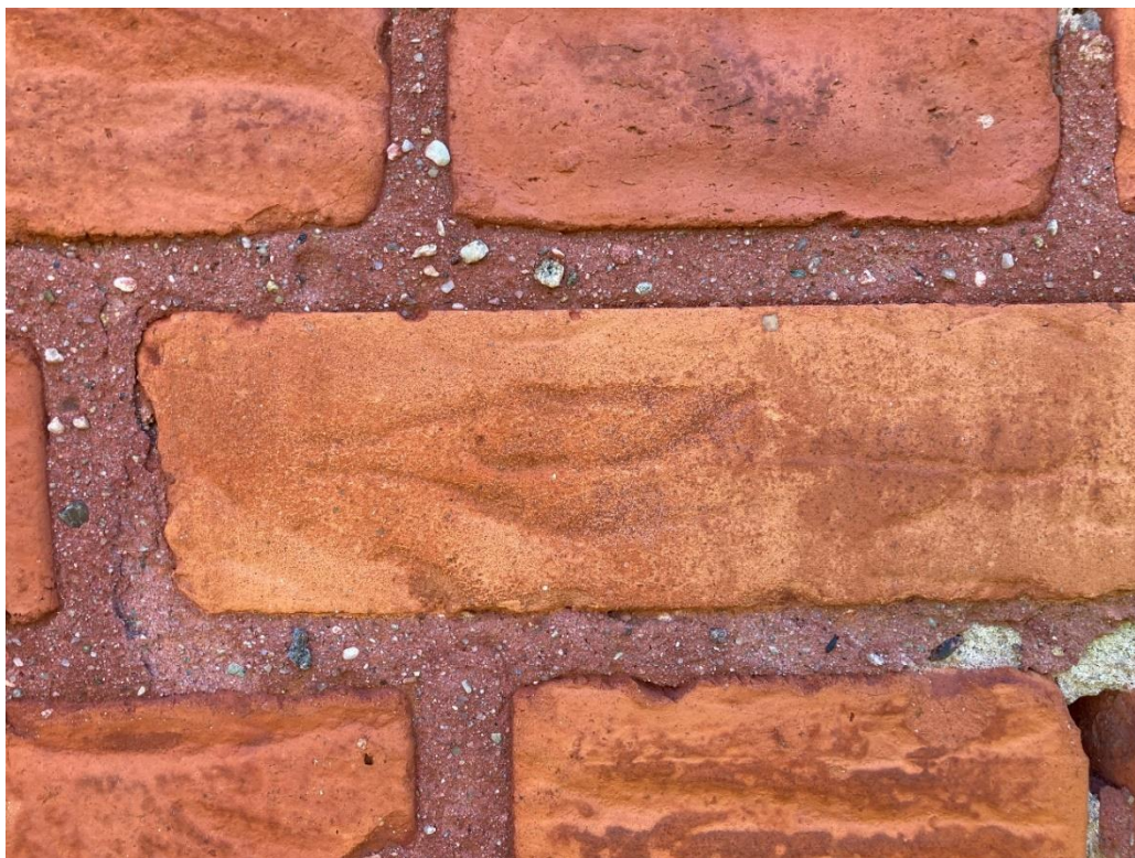
Foto 18. Typiske skader på mursten
